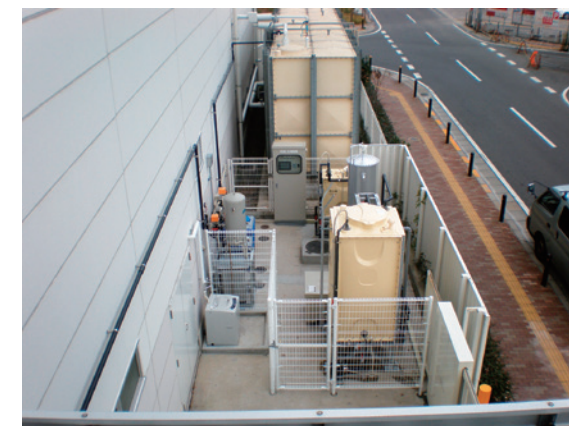
膜ろ過システムの設備全景
